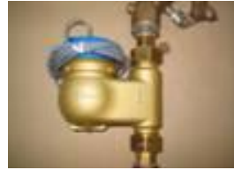
Bauwasserzähler mit Standrohr Q4 7 m 3
